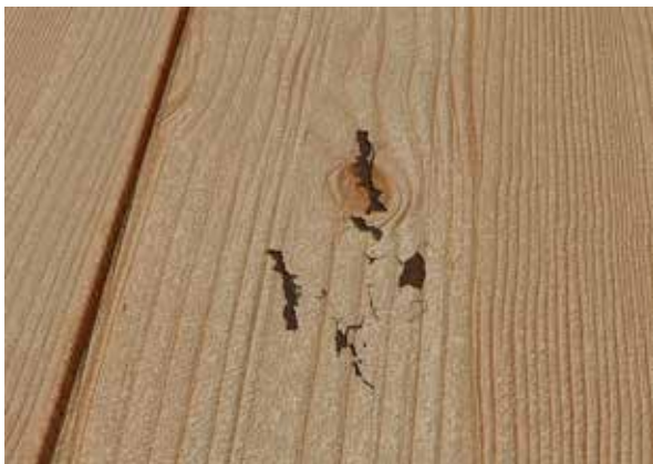
Schilfer/Ablösung der Jahringe bei Nadelhölzern; darüber trockenbedingter Riss im gesunden Ast
