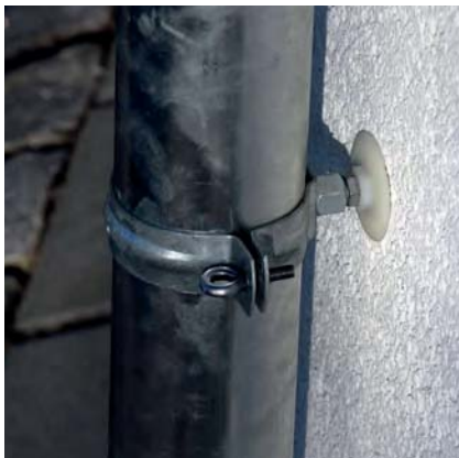
IPL 95DS installiert
